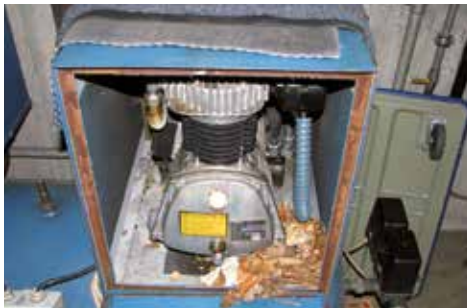
Abb. 1: Gesamtansicht der Kompressorpumpenkammer mit Einhausung und Siebenschläfer-Nest in der rechten Ecke unmittelbar neben der Pumpe. Blick von vorne bei aufgeklappter Vorderwand.
